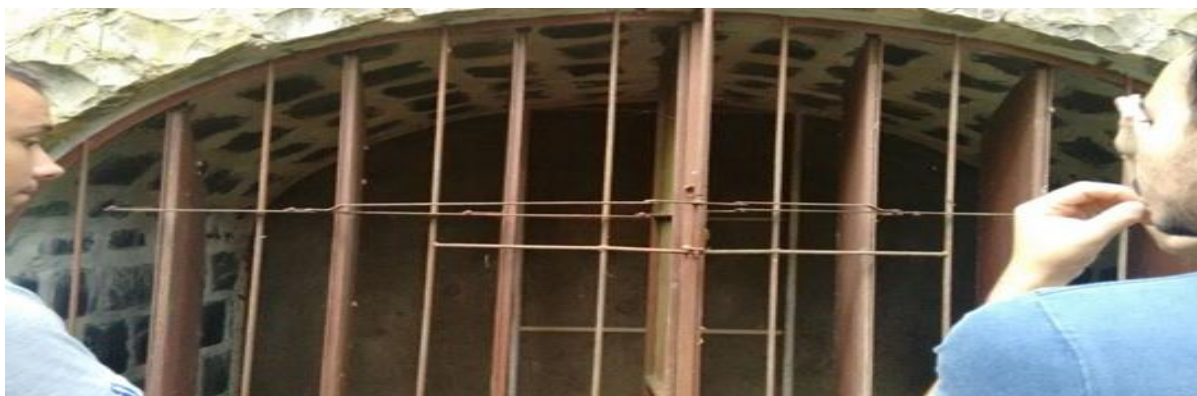
Figura 20- Fechamento manual da captação de ar do túnel
