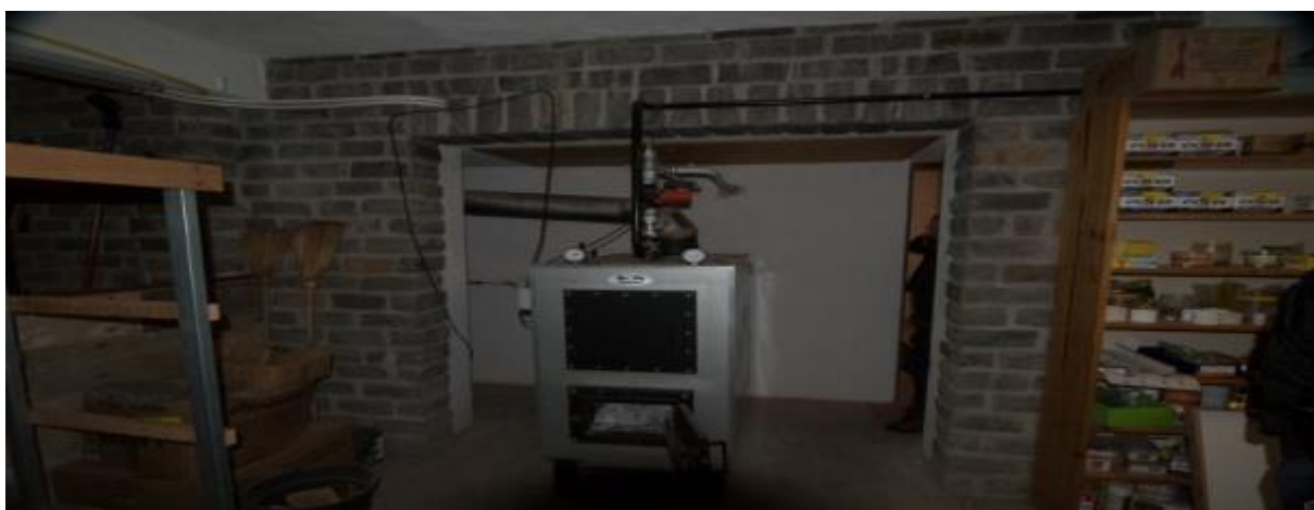
Figura 21- Caldeira com Sistema Pex
